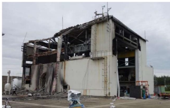
真空燃焼試験棟(爆発後)
