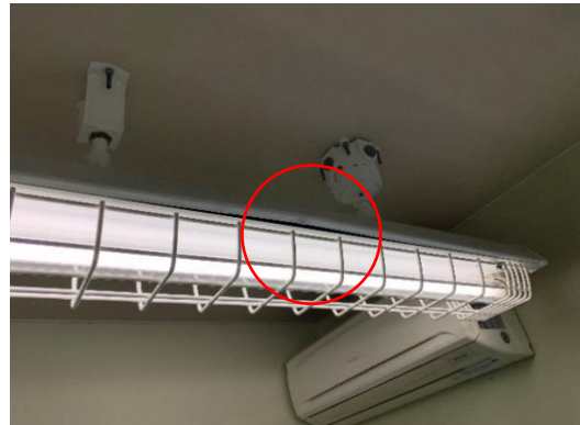
写真 19 蛍光灯の変形箇所 (丸印) (調査時)
